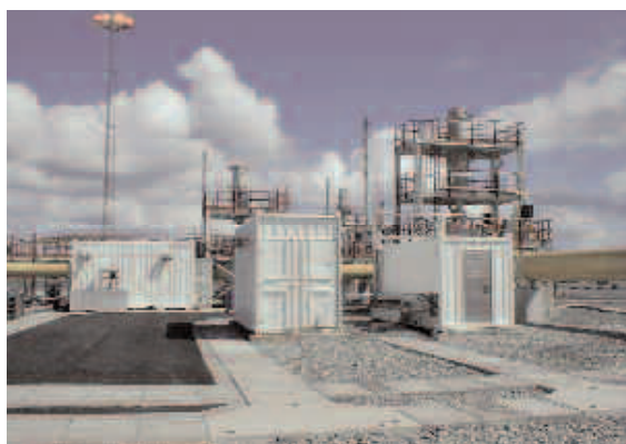
Anno 1999: Haugesund Norvegia. Attuatore Ledeen/Grove per valvola pipeline da 42". L'impianto oleodinamico, tutto in acciaio Inox, contenuto nei Container è della Hydros.
